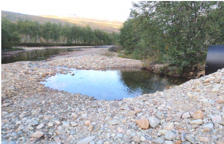
Figur 73 Erosjonsgrop ved kulvertutløp (Vinddølaldalen)
