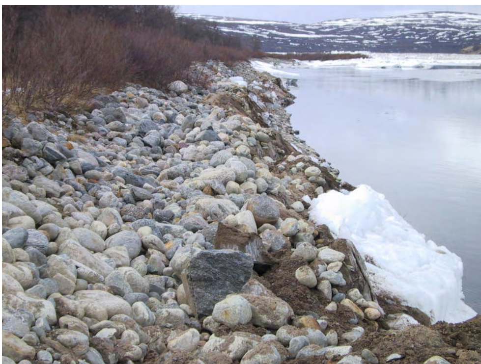
Figur 18 Forbygning skadet av isgang (foto: K. Hoseth)
