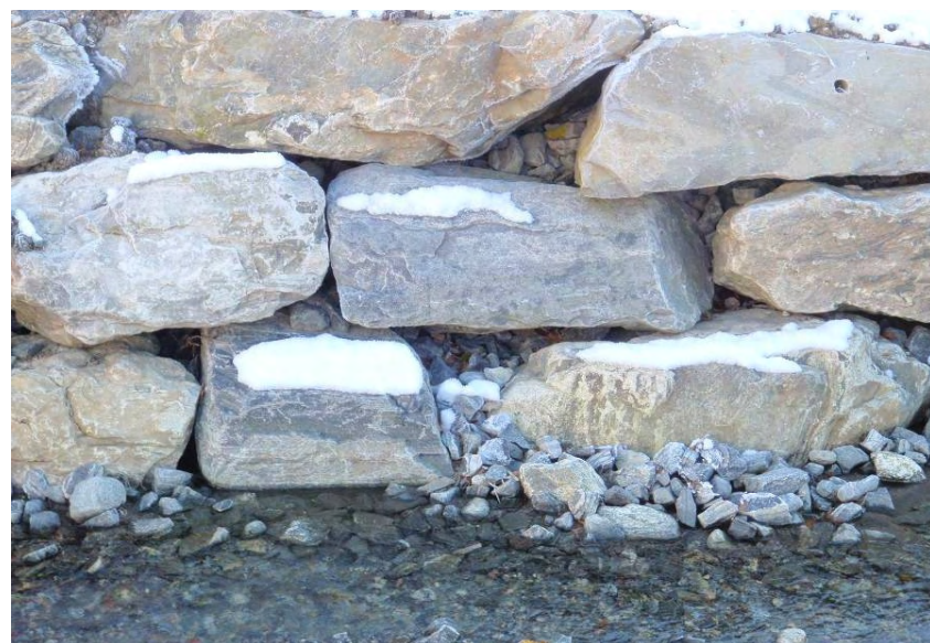
Figur 72 Filteret må tilpasses åpningene i plastringen. Her er åpningene for store slik at filteret vaskes ut
